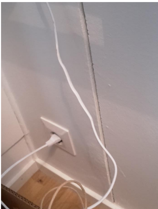
Bild 1.1. Spånskiva som svällt på yttervägg mot innergård.
