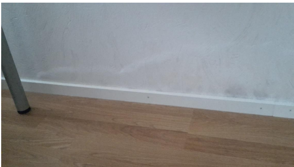
Bild 1.2. Tapeter har släppt på gavelytterväggen till följd av fuktbelastningen.
