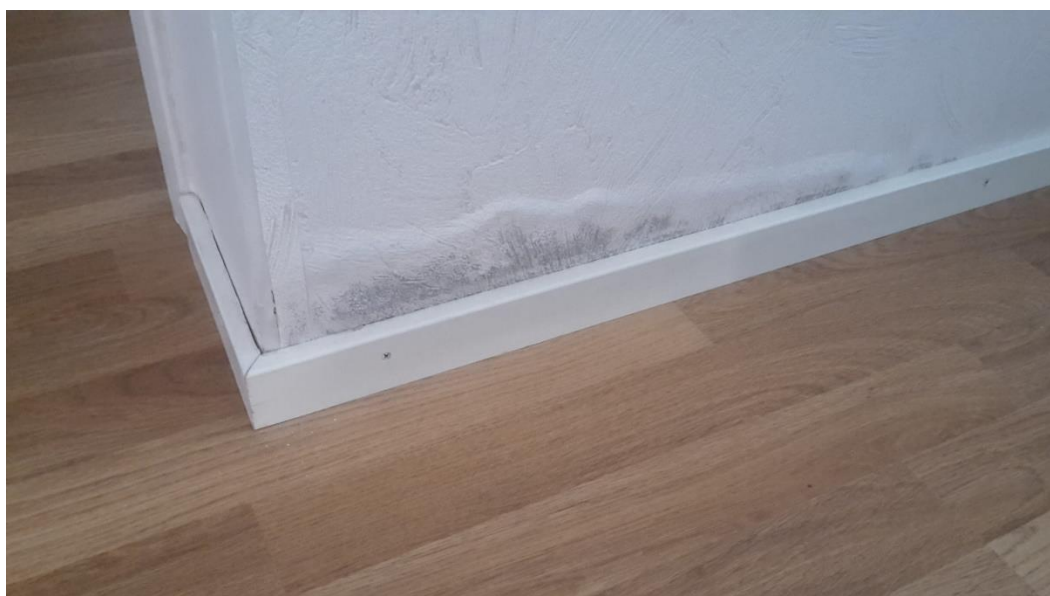
Bild 1.3. Tapeter har släppt på innervägg till följd av fuktbelastningen.
